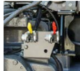
■ Eine vollwertige Druckluftanlage steht für Anbaugeräte mit Druckluftbremsanlage zur Verfügung.
